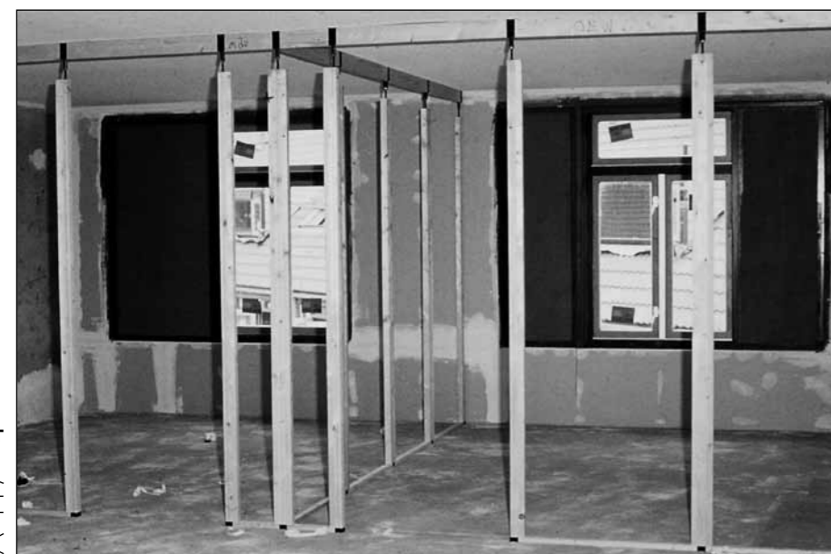
De flexibele wanden worden uitgezet. Later zullen beplating en binnendeuren worden aangebracht. Op de achtergrond de gevel. De donkere delen zijn raamopeningen die met een paneel zijn dichtgezet. Als de ruimten achter de gevel groter worden kan er alsnog glas worden geplaatst.
