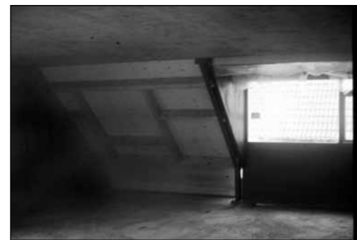
In het dak zijn extra balken aangebracht voor het aanbrengen van extra dakramen.
