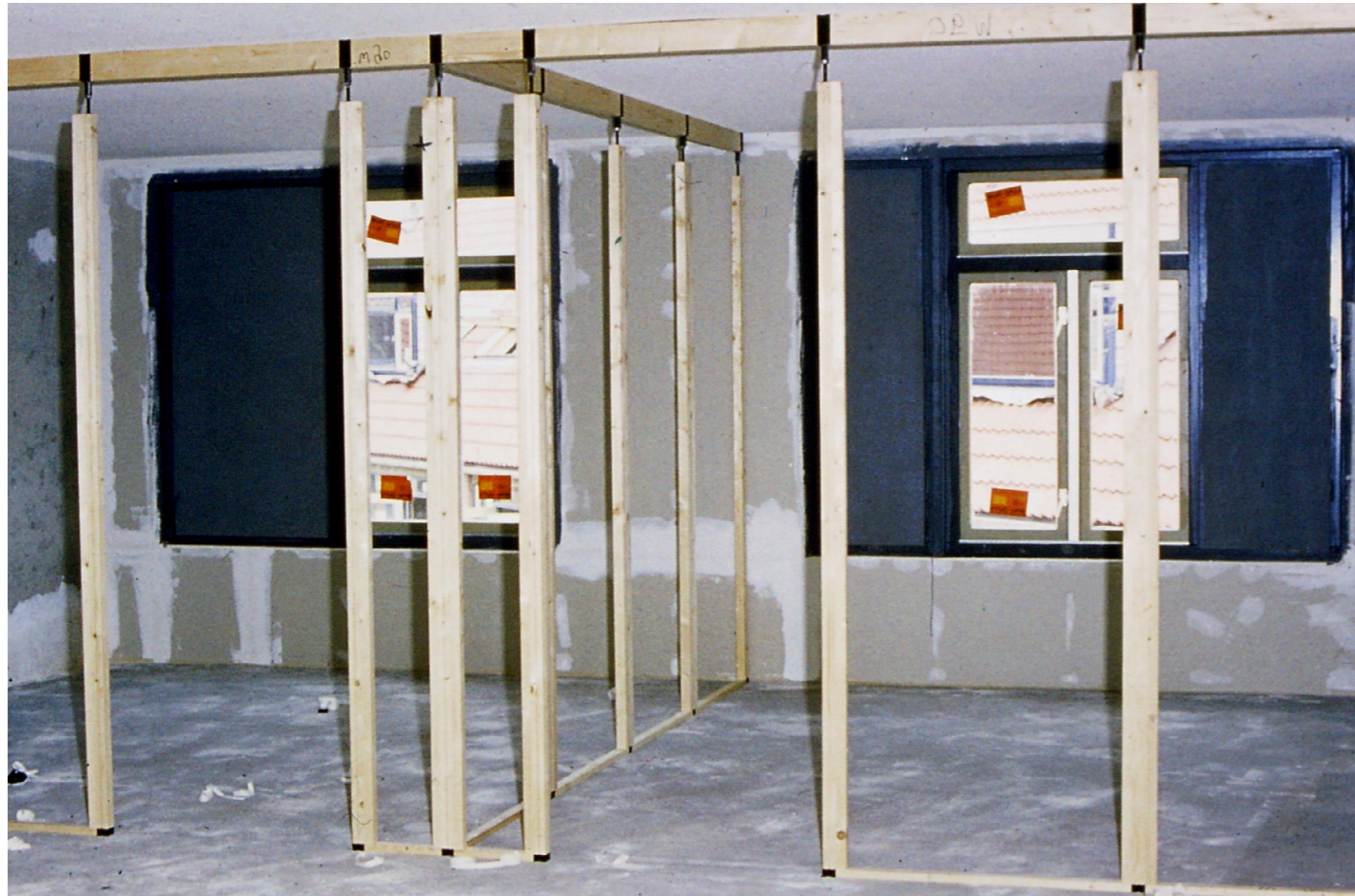
Flexibel Bruynzeel binnenwandensysteem, Centraal Wonen Nieuwegein (architect Flip Krabbendam, 1981-1982)
